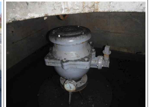
밸브실 내부 전경
