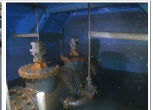
밸브실 내부 전경
