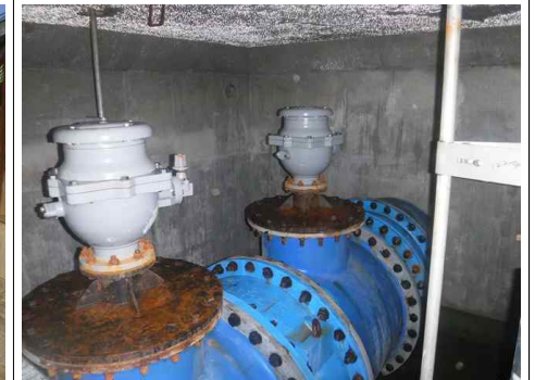
밸브실 내부 전경
