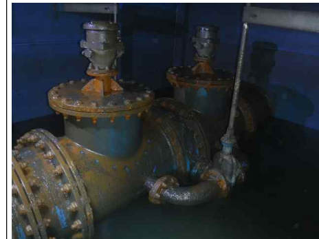
배관 및 밸브 상태
