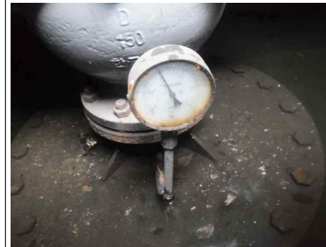
수압계 작동상태 양호
