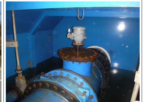
밸브실 내부 전경
