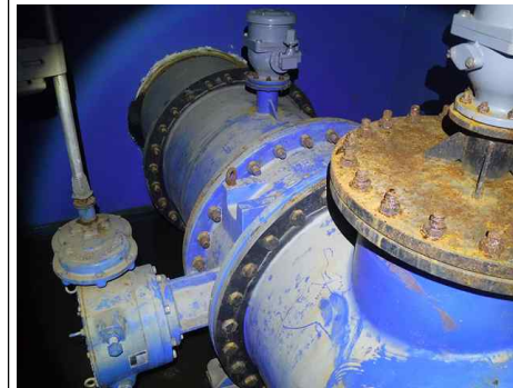
배관 및 밸브 상태
