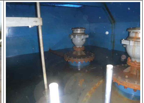
밸브실 내부 전경
