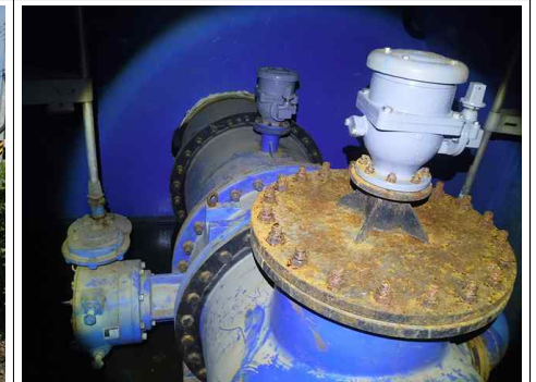
밸브실 내부 전경
