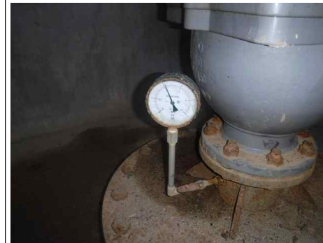
수압계 작동상태 양호
