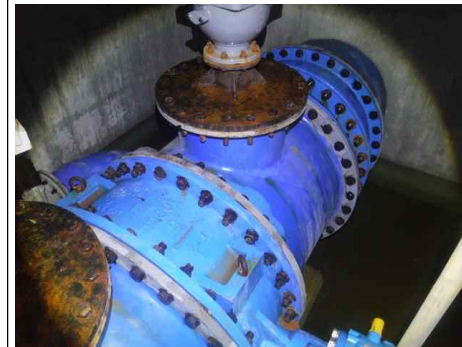
배관 및 밸브 상태
